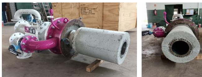
Novo queimador instalado na Fábrica Maceira-Liz
