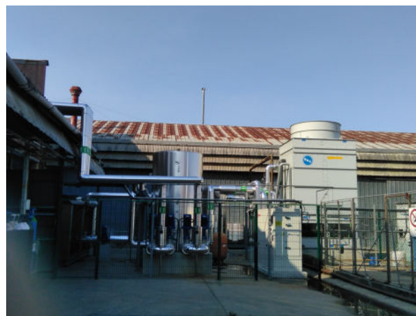
Figura 44 - Sistema de refrigeração de água industrial.
