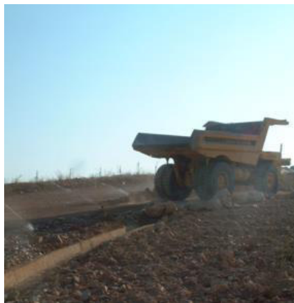
Sistema de aspersão automática ao longo de troço da estrada principal da pedreira de calcário (MTD 15.d).
