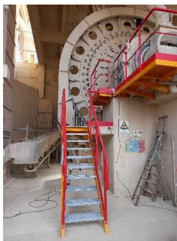
Exemplo de uma das plataformas de segurança executada (acesso a um dos moinhos da moagem de cru).
