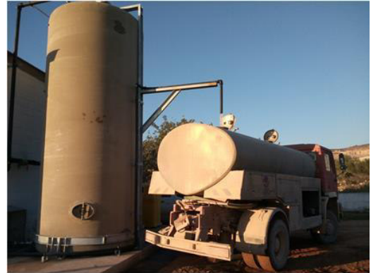
Reaproveitamento da água de lavagem dos filtros de areia e descalcificação da ETA, para rega dos caminhos da pedreira.
