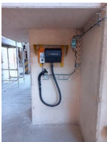
Exemplo de uma das estações de limpeza de vestuário (do tipo mural com tecnologia da empresa JetBlack ). Alternativa ao uso de ar comprimido e com menores emissões de ruído para os trabalhadores.
